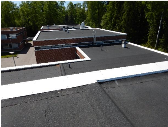
Kuva 1: Kattoalueet ovat kuivat.
